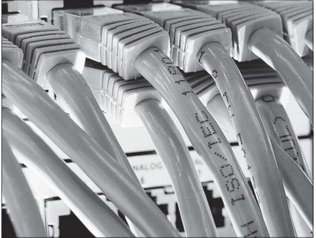
Netzwerkabel stecken in einem Server. Die IT-Branche in Sachsen-Anhalt sieht sich gut gerüstet. Foto: dpa
